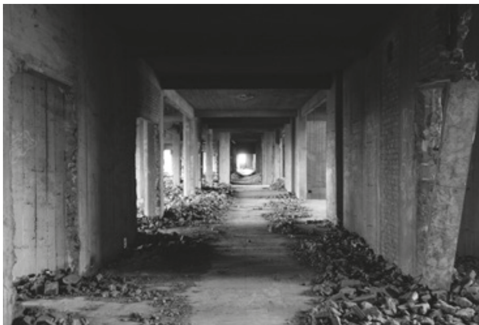
FIG. 8. QUATRIÈME ÉTAGE INACCESSIBLE DE EL ELEFANTE BLANCO. POUR ACCÉDER AUX ÉTAGES SUPÉRIEURS CONDAMNÉS, UNE ÉCHELLE A DÙ ÊTRE POSITIONNÉE DANS LES CONDUITS PRÉVUS POUR RECEVOIR LES ASCENSEURS DE L'HÔPITAL. © PHOTO : TIPHAINÉ ABENIA, 2013.
