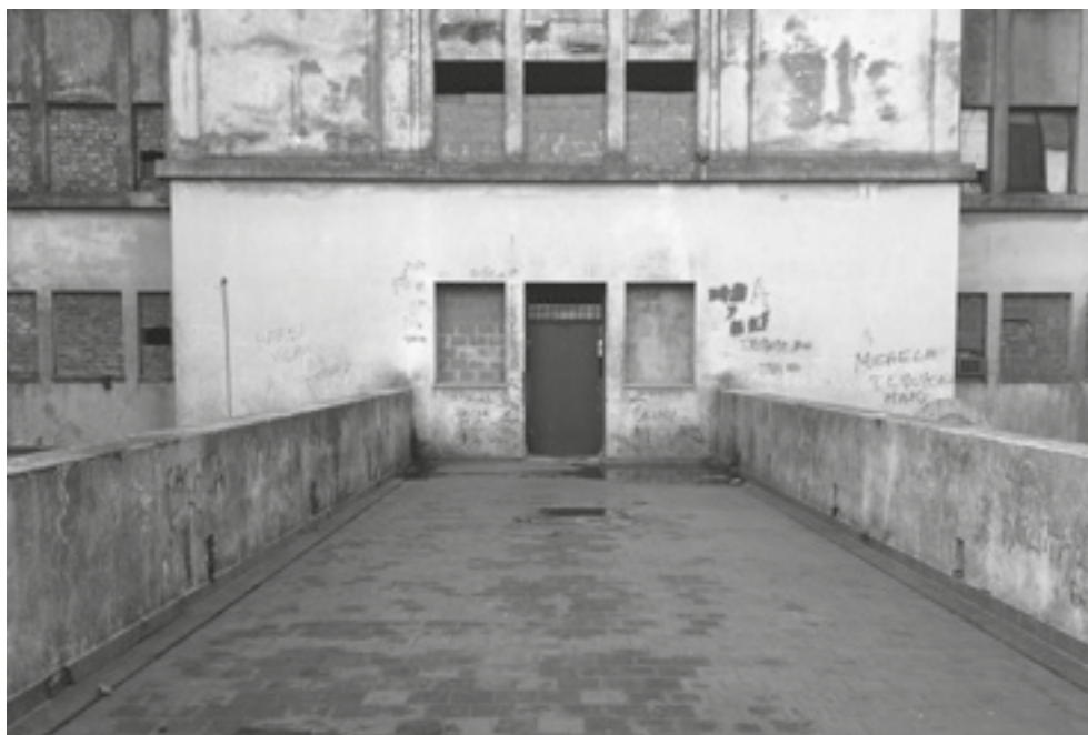
FIG. 10. FENÊTRES CONDAMNÉES DONNANT SUR LES PATIOS. © PHOTO : TIPHAINE ABENIA, 2014.
