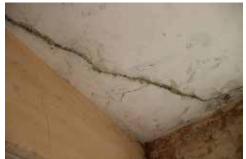
Apparition de mousse à l'intérieur du bâtiment (absorption d'eau, gonflement et dilatation de la ferraille du béton)
