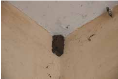
Vue d'un nid d'insectes destructeurs
