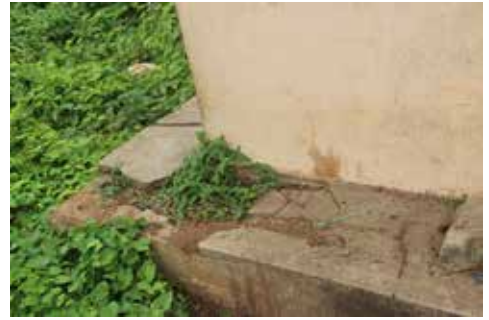
Etat du côté latéral ouest de la terrasse du bâtiment
